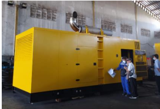
Gambar 3.20 Kunjungan dan Loading Test Genset 1000 kVA
