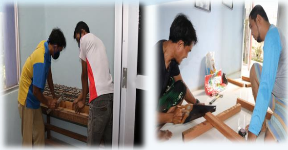
8 – 19 Juni 2020, Renovasi Laboratorium PCR di Balai POM di Jambi untuk Pengujian Covid-19
