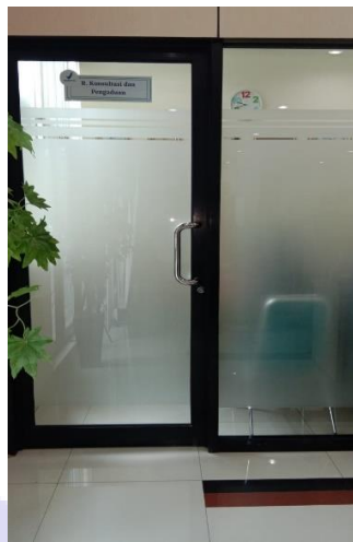
Gambar 19 Ruang tertutup untuk pengaduan
